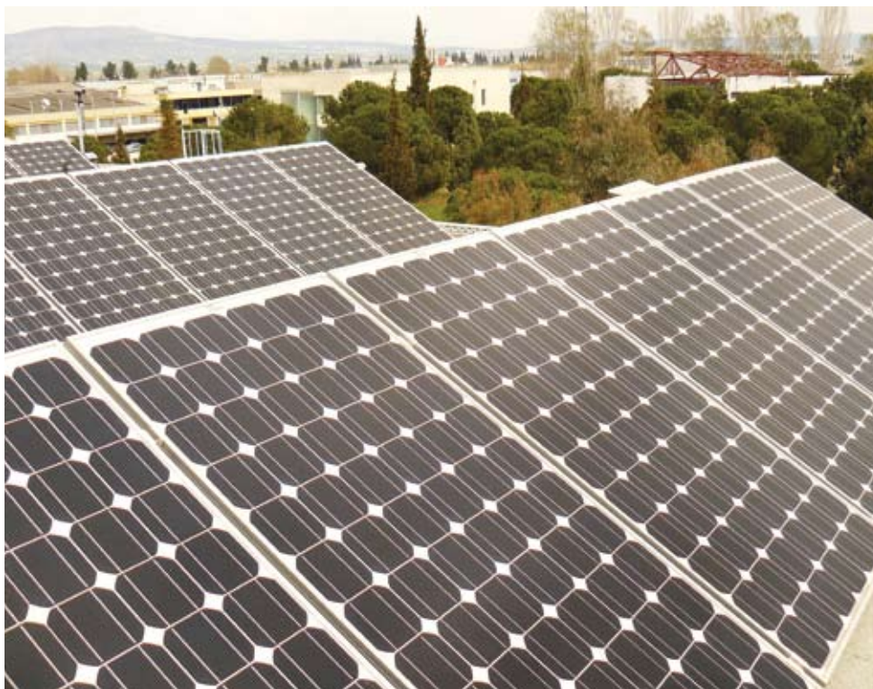
> Εγκατάσταση φωτοβολταϊκού σταθμού ισχύος 9,57 KW στο Κατάστημα της Τράπεζας Πειραιώς στη ΒΙΠΕ Σίνδου
