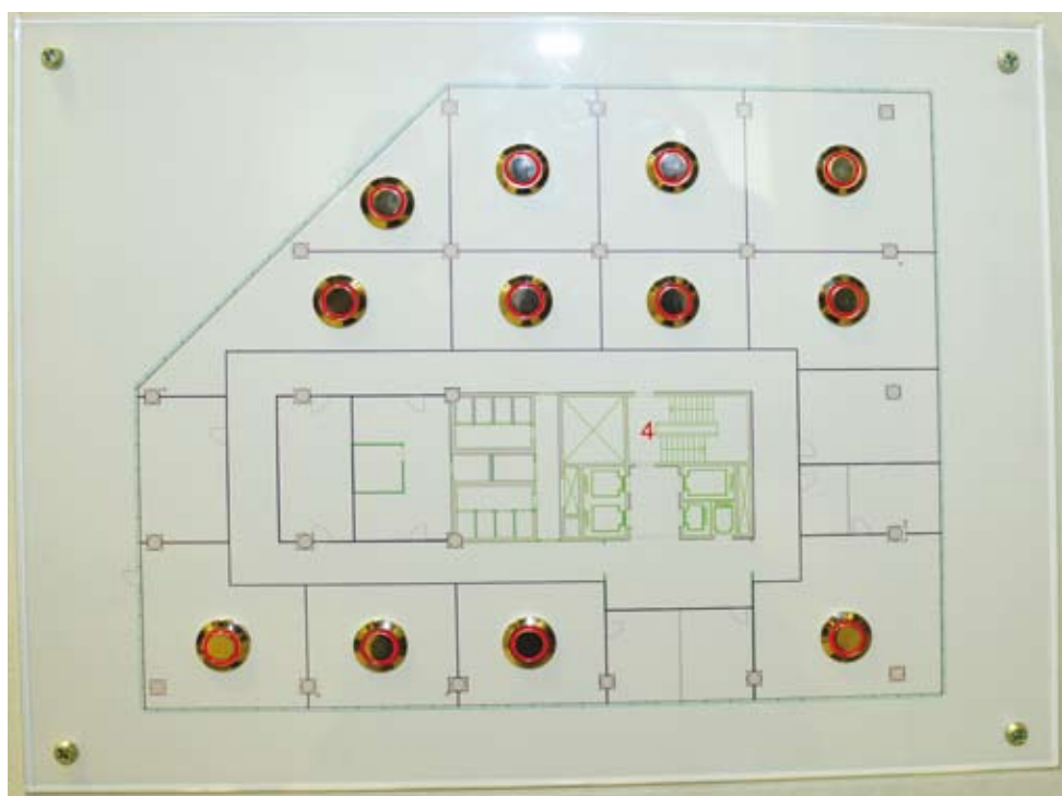
➤ Πίνακας ελέγχου φωτισμού στο κτήριο της Τράπεζας Πειραιώς στη Λ. Συγγρού 87
