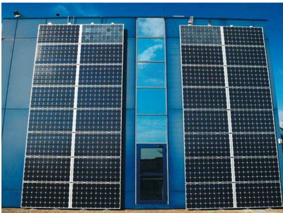
➤ Εγκατάσταση 5,4 KW φωτοβολταϊκών συστημάτων στο κτήριο της Τράπεζας Πειραιώς στη Συγγρού 87
