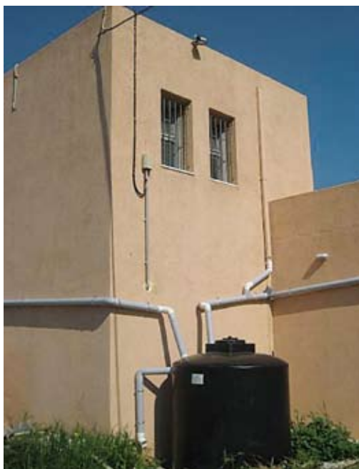
> Δεξαμενή συλλογής βρόχινου νερού στο Κατάστημα της Τράπεζας Πειραιώς στην Τζια (Κέα)
